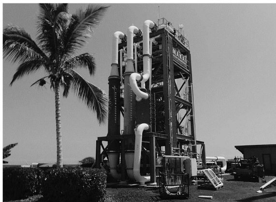
図7 ハワイ島コナで稼働中の100 kW OTEC実験プラント
