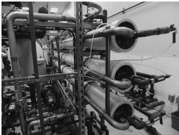
図10 ハワイ島コナにある飲料水生産工場の逆浸透膜ユニット
