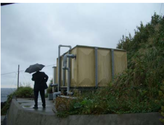
図3 ケーソン式深層水取水ピット
